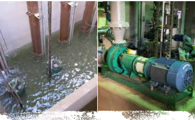
Filtrados de estación de redes de alcantarillado
