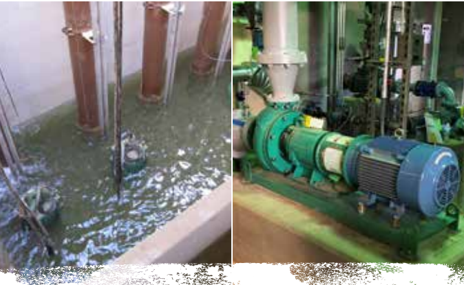
Filtrados de Estación de Redes de Alcantarillado
