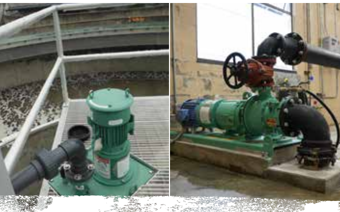
Schlamm aus Vorklärbecken
